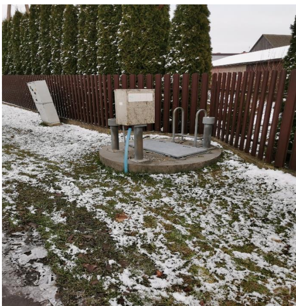
Przepompownia ul. Zarzecka – pompy AS0840.128-S17/2
